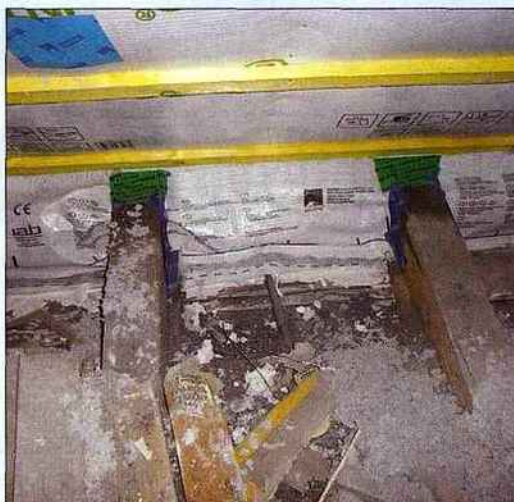
L'insuffisance de ventilation sur le chantier a donné lieu à un phénomène de condensation sur ces têtes de solives.
